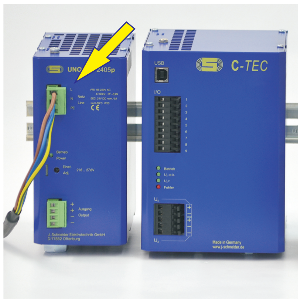
Anschluss des 24VDC Netzgerätes an das Versorgungsnetz (230VAC)
